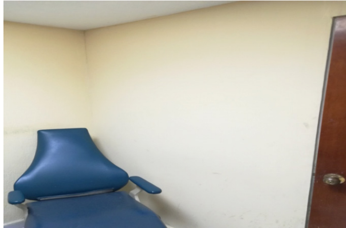
Imagen 1. Paredes sin el forro de plomo
