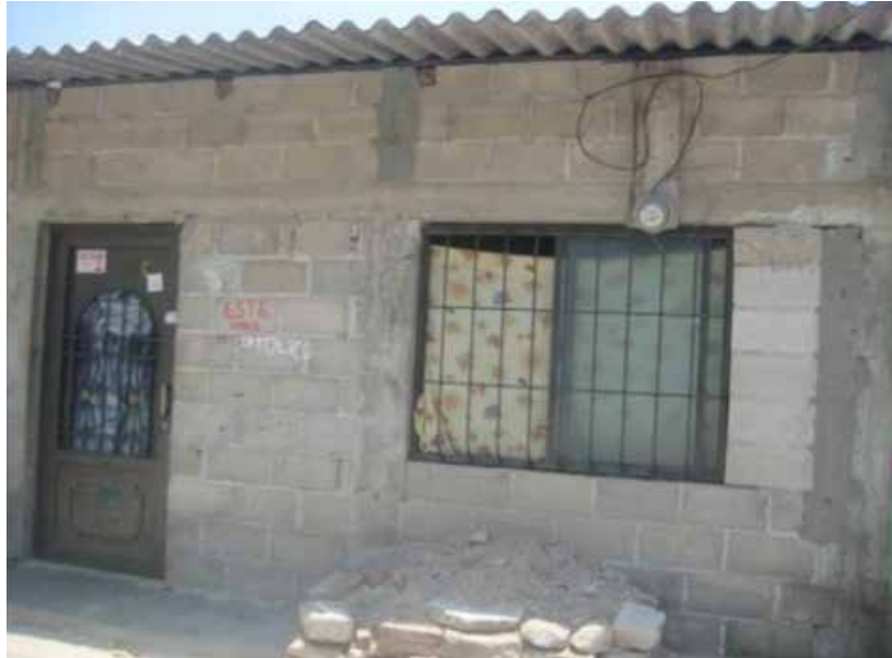
Imagen 7. Ausencia de refuerzo vertical en vanos. Fuente: Elaboración propia
