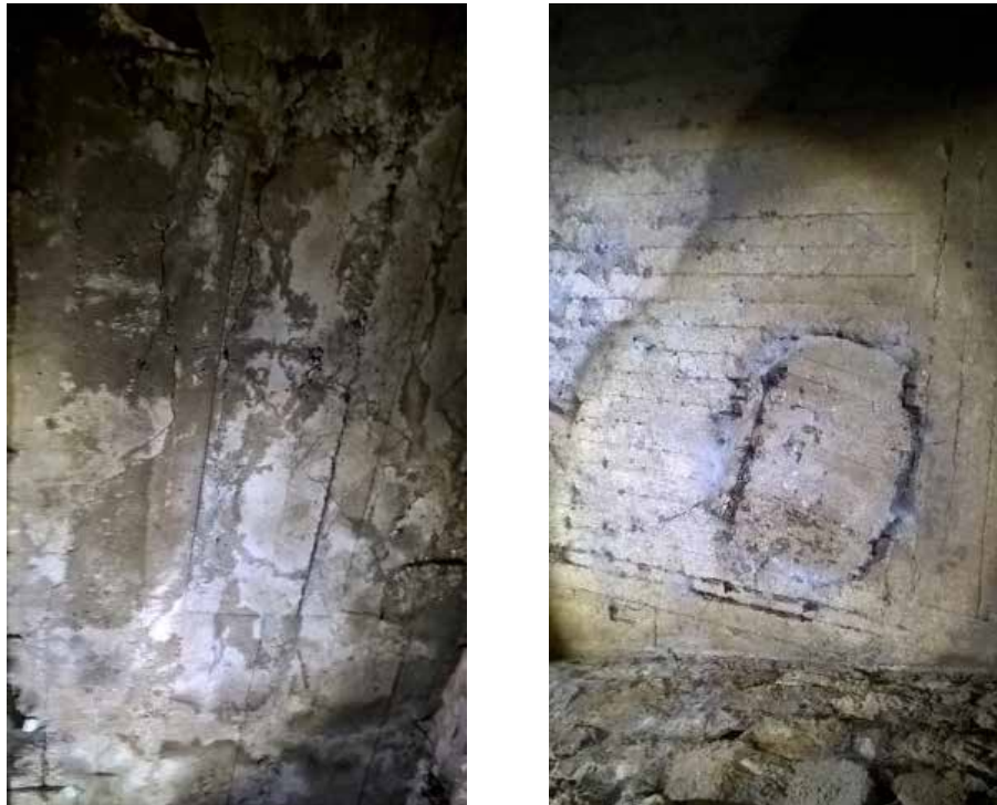
Figura 4. Fallas en los materiales: a) Agrietamientos y b) Reventones en losa a) b)
