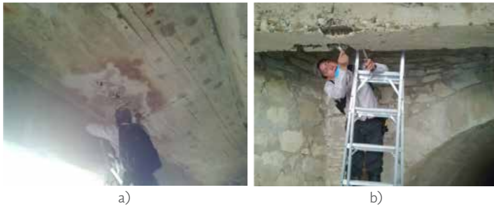
Figura 14. a) Medición de deterioros (segregaciones) en losa y b) medición de segregaciones en viga con vernier digital "Mitutoyo" y escala milimétrica transparente
