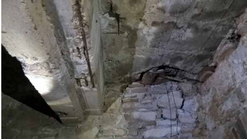
Figura 6. Vista general de losa y vigas con diversas patologías (Mundo, 2019)
