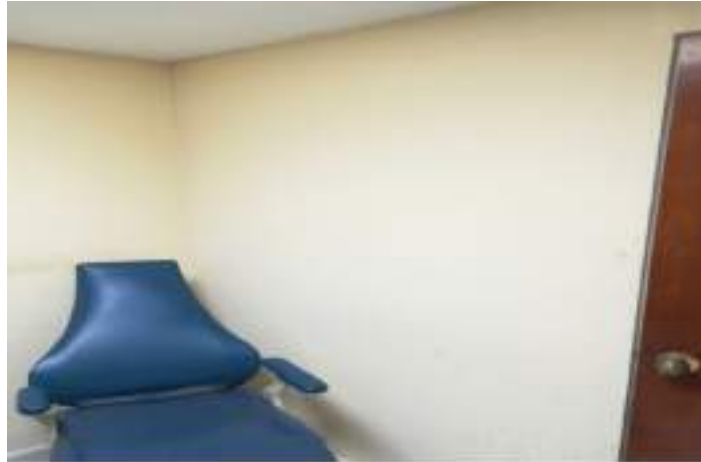
Imagen 1. Paredes sin el forro de plomo
