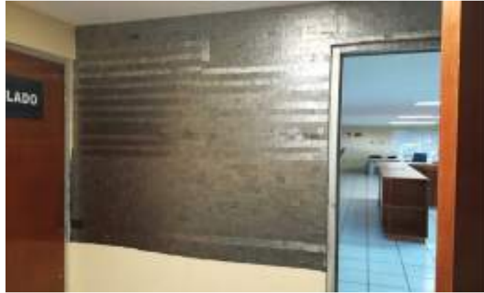
Imagen 3. Pared en proceso de forrado con laminillas de plomo, material contaminante de desecho radiográfico
