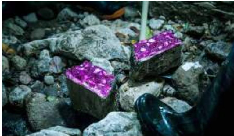
Figura 11. Medición de la Carbonatación en muestras de concreto de la losa in-situ , mediante una solución indicadora ácido-base: Fenolftaleína (Tavera, 2018)
