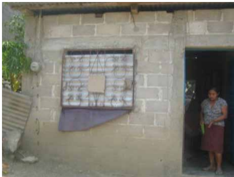
Imagen 8. Ausencia de refuerzo horizontal en ventana. Fuente: Elaboración propia
