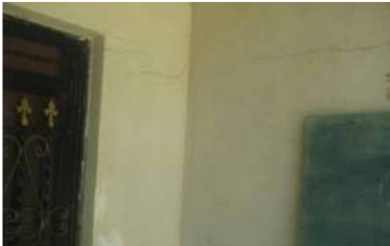
Imagen 5. Fisuras en intersección de muros. Fuente: Elaboración propia
