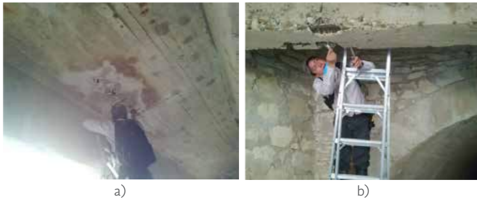
Figura 14. a) Medición de deterioros (segregaciones) en losa y b) medición de segregaciones en viga con vernier digital "Mitutoyo" y escala milimétrica transparente
