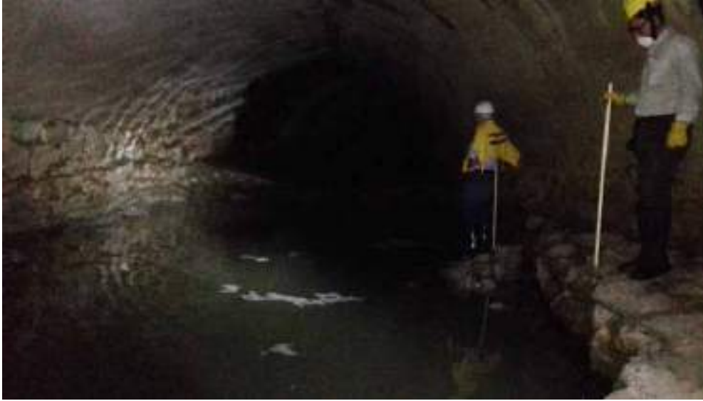
Figura 2. Aguas negras que circulan en el “Embovedado San Roque”
