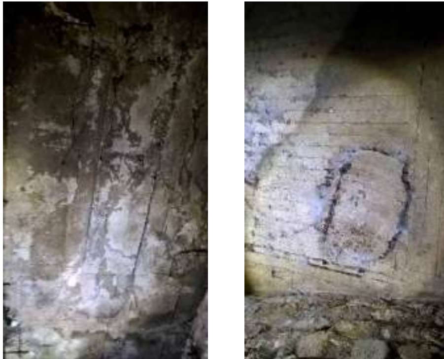
Figura 4. Fallas en los materiales: a) Agrietamientos y b) Reventones en losa a) b)
