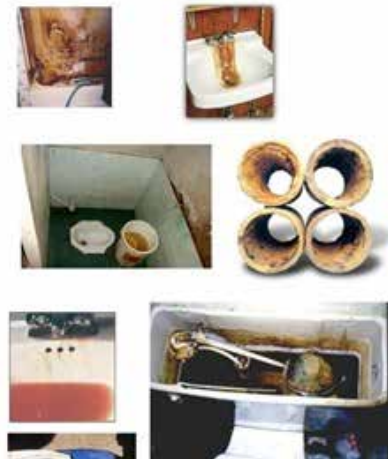
Figura 9. Incrustaciones y manchas en los muebles de baño. Fuente: Hidroquil, 2019
