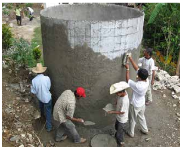
Figura 2. Colector de agua de lluvia de ferrocemento (SEDEPAC, 2021)
