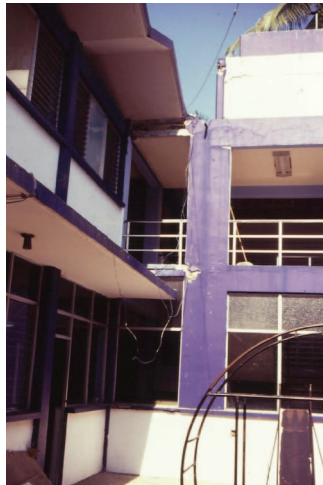
a) Por asentamientos diferenciales
