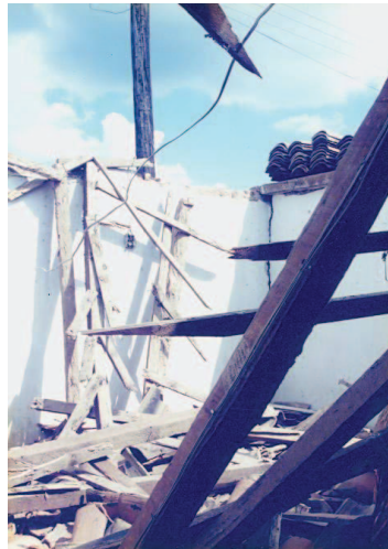
Figura 9. Daños y demolición de la iglesia del Nazareno, Villaflores, Chiapas (Fotografías cortesía del Ing. José Alfredo Chan)
