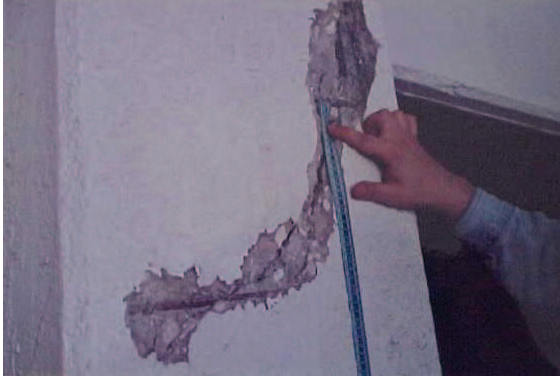
Figura 5. Daños en columnas
