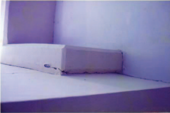
Figura 18. Daños en estructura de concreto y mampostería del Palacio de gobierno en la ciudad de Tuxtla Gutiérrez (Fotografías cortesía de Ing. José Alfredo Chan)
