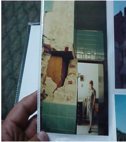
Figura 5. Daño en muro de mampostería sin refuerzo (Fotografía cortesía de Raúl Vera Noguez)
