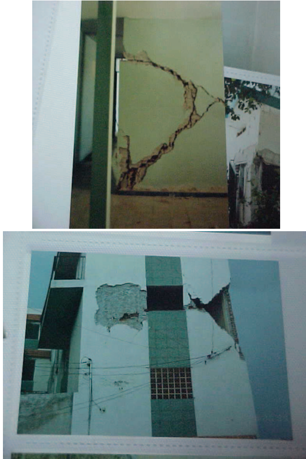
Figura 9. Daños en muros de mampostería sin refuerzo (Fotografía cortesía de Raúl Vera Noguez)
