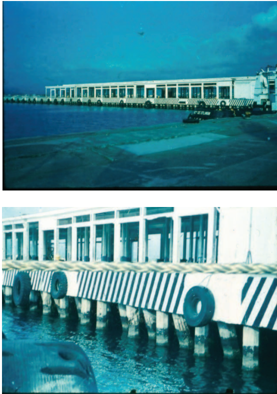
Figura 4. Daños observados en los pilotes del viejo muelle fiscal del puerto de Manzanillo (fotos cortesía de Óscar de la Torre Rangel)
