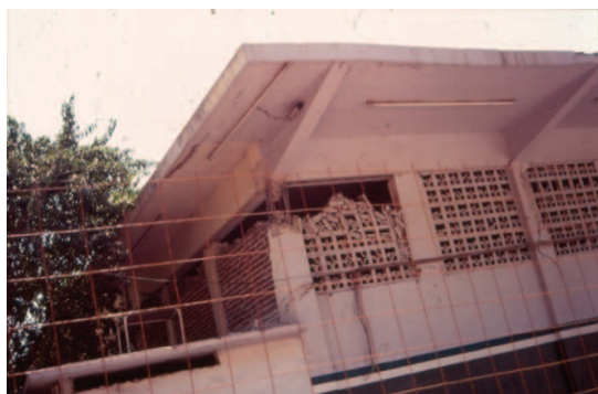
Figura 6. Columnas cortas en el edificio de la Terminal de Autobuses de Manzanillo.
