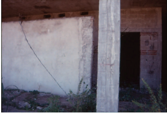
Figura 12. Daño observado en la obra negra de la autoconstrucción que irresponsablemente pretendía ser un hospital privado en las afueras de Manzanillo.
