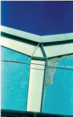
a) Daño en el muro
