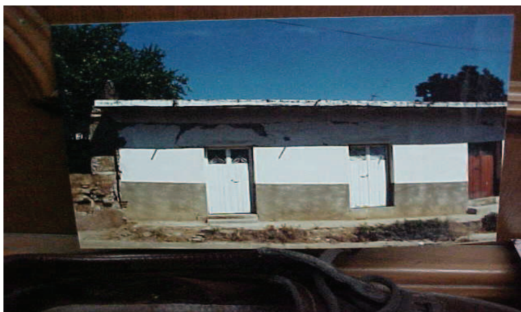
Figura 4. Grietas por flexión en muros de mampostería (Fotografía cortesía de Raúl Vera Noguez)
