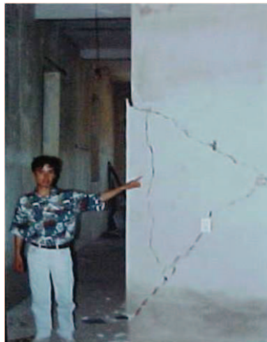
Figura 16. Daños en mampostería sin refuerzo, debidas al comportamiento frágil del muro para esfuerzos de tensión y corte (fotografía del M.I. Raúl Vera Noguez)
