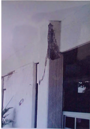
Figura 26. Daños en muros y columnas del edificio de rectoría de la UNACH (Fotografías cortesía del M.C. Jorge Alfredo Aguilar Carboney)
