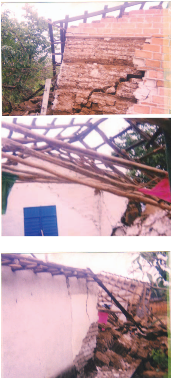
Figura 3. Daño en estructuras de adobe en la población de Nuevo México, municipio de Villaflores (Fotografías cortesía del Ing. José Alfredo Chan)
