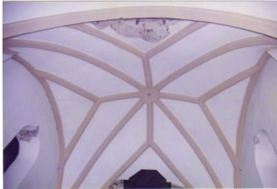
Figura 23. Daños en estructuras de iglesias y centros de culto. Daños en una cúpula y muros de la catedral de San Marcos en Tuxtla Gutiérrez (Fotografías cortesía del Ing. José Alfredo Chan)
