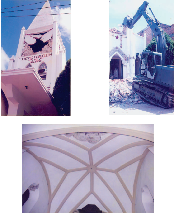
Figura 4. Daños en estructuras de iglesias y centros de culto. Las primeras dos fotografías corresponden a una iglesia en Nuevo México, Municipio de Villaflores y la tercera muestra daños en una cúpula de la catedral de San Marcos en Tuxtla Gutiérrez, fotografías cortesía de Ing. José Alfredo Chan Chin.
