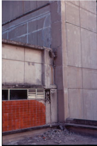
Figura 23. Daños ocasionados por el choque estructural entre el edificio principal y el anexo.
