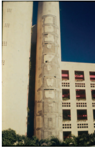
Figura 33. Daño no estructural en el cubo de escaleras del hotel Westin Regina (foto cortesía de Eduardo Miranda).
