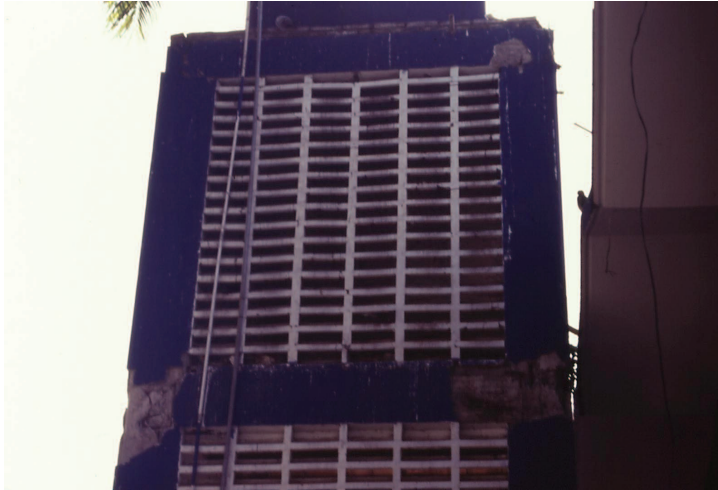
b) En el nudo del cubo de escaleras Figura 18. Daño observado en el Hospital de la Secretaría de Salud.
