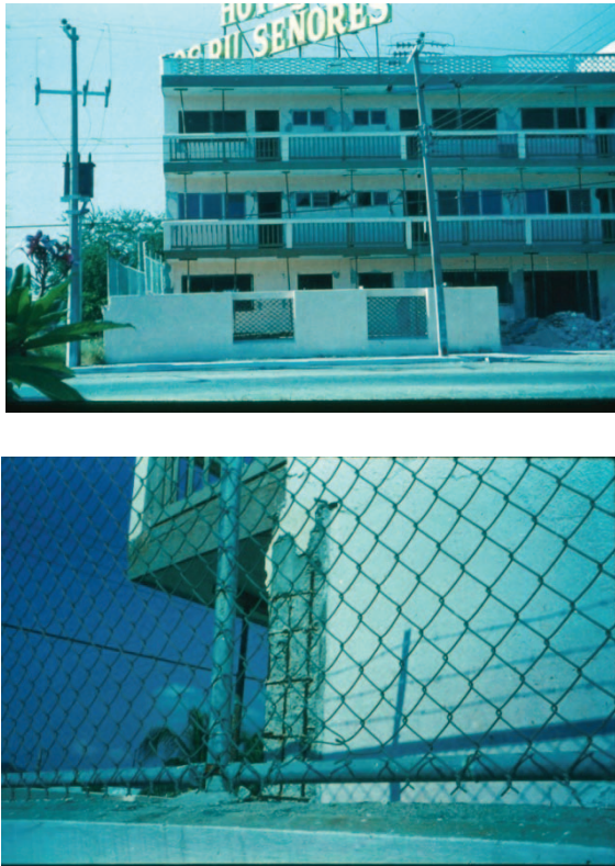
Figura 29. Vistas generales del daño típico presentado en el Hotel Los Ruiseñores (fotos cortesía de Óscar de la Torre Rangel).
