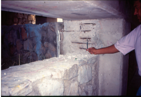
Figura 21. Daño en columnas del sótano del edificio principal del HGZ-10 del IMSS.
