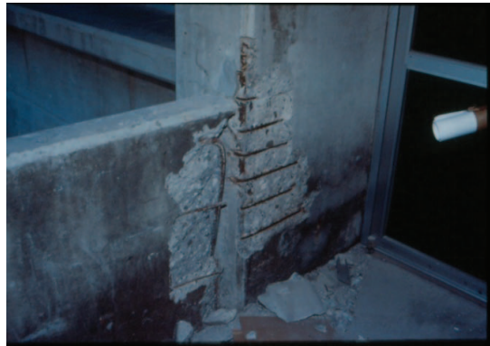
Figura 24. Daños ocasionados por el choque estructural entre el edificio principal y escaleras de emergencia.
