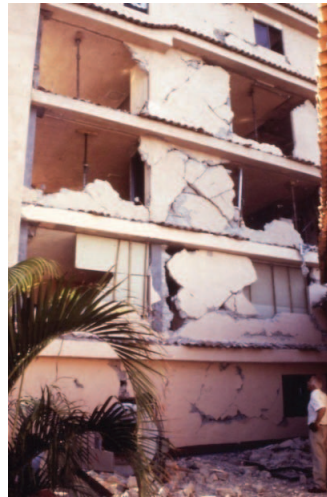
b) Daño en muros y en los marcos
