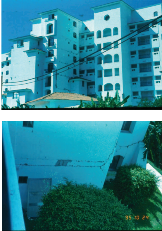
Figura 30. Vistas generales del daño típico presentado en el Hotel Delfos por su gran flexibilidad lateral (fotos cortesía de Amador Terán Gilmore).
