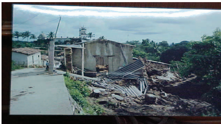
Figura 3. Colapso de estructura por no considerar las condiciones naturales del terreno al momento de diseñar la cimentación (Fotografía cortesía de Raúl Vera Noguez)
