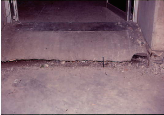
a) Asentamiento del terreno en salida de emergencia
