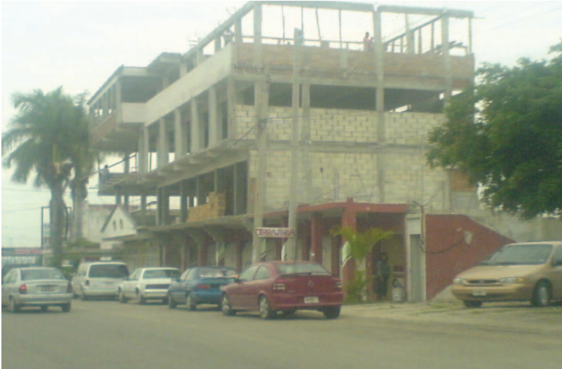
Figura 20. Irregularidad de un edificio que se emplea como oficinas del Instituto Federal Electoral en la ciudad de Tuxtla Gutiérrez
