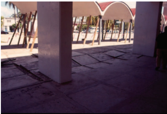
Figura 3. Daños debido a licuación de arenas en las instalaciones de la Unidad Médica Familiar UMF-2 del IMSS.
