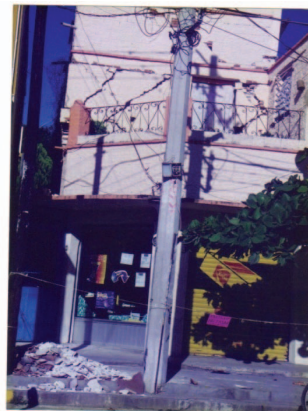
Figura 6. Daños en la cabecera municipal de Villaflores (Fotografía cortesía del Ing. José Alfredo Chan)
