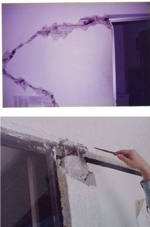
Figura 7. Daños en la presidencia municipal de Villaflores (Fotografías cortesía del Ing. José Alfredo Chan y del M.I. Raúl Vera Noguez)
