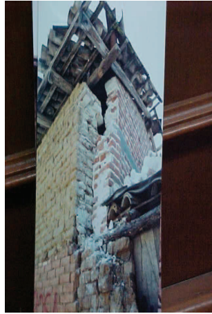
Figura 2. Daños en estructuras de adobe donde la poca resistencia del material y el efecto del diafragma flexible causa daños muy importantes (Fotografías cortesía de Raúl Vera Noguez)
