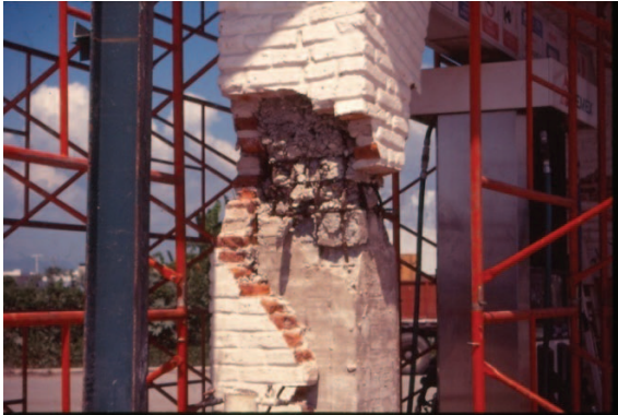
Figura 7. Daño observado en una gasolinera de Manzanillo. Una estructura similar contigua colapsó.
