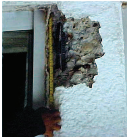
Figura 21. Una de las fallas más comunes en estructuras de concreto es la separación de los estribos, ya que genera una falta de confinamiento (Fotografías cortesía del M.I. Raúl Vera Noguez)
