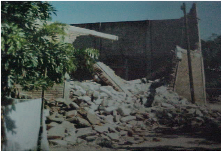
Figura 11. Daños en muros de mampostería confinada mal detallada (Fotografía cortesía de Raúl Vera Noguez)
