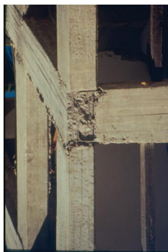
c) Falla de adherencia en el nudo, Hotel Vallarta Beach
