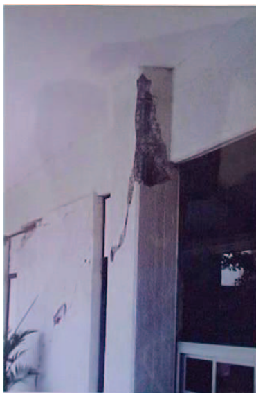
Figura 4. Daños en columna con pretel superior
