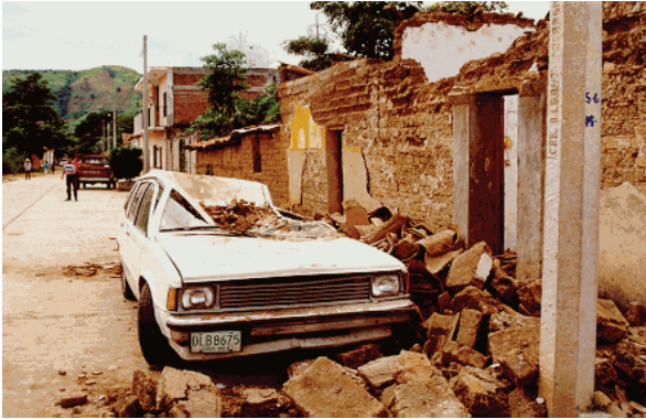
Figura 2. Daño en estructuras de adobe en la población de Jesús María Garza, municipio de Villaflores (Fotografías cortesía del Ing. José Alfredo Chan)
