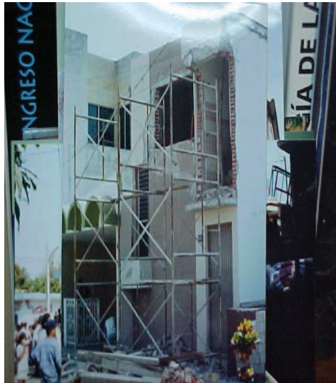
Figura 10. Daños en muros de mampostería sin refuerzo en el estado de Colima (Fotografía cortesía de Raúl Vera Noguez)
