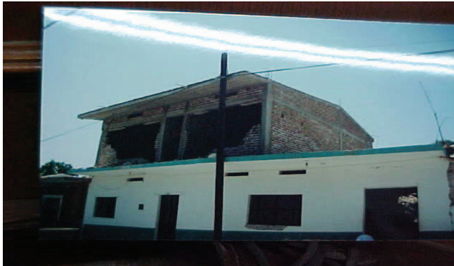
Figura 8. Daños en vivienda de mampostería confinada en la cabecera municipal de Villaflores (Fotografía cortesía del M.I. Raúl Vera Noguez)
