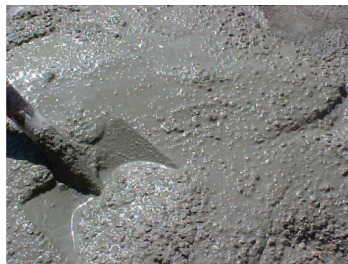
Figura 4 (a y b). Elaboración de mortero cemento arena con exceso de agua, lo que le provocará fisuraciones y pérdida de resistencia
