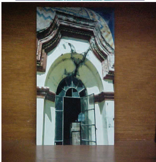
Figura 6. Daños en estructuras de iglesias en sus muros de mampostería sin refuerzo y/o adobe (Fotografía cortesía de Raúl Vera Noguez)
