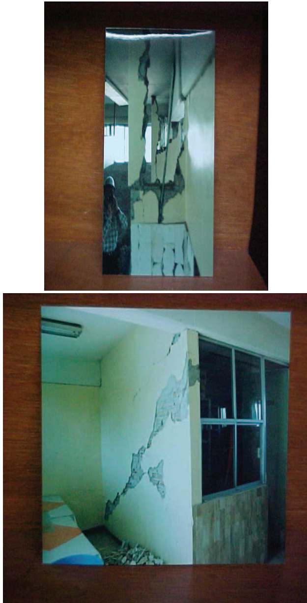
Figura 8. Daños en muros de mampostería, los cuales se vincularon indebidamente a la estructura (Fotografía cortesía de Raúl Vera Noguez)
