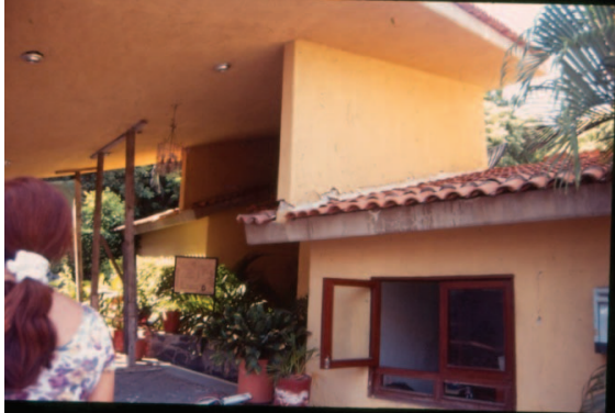
Figura 10. Daños típicos observados en estructuras de mampostería no confinada del conjunto Plaza Las Glorias.
