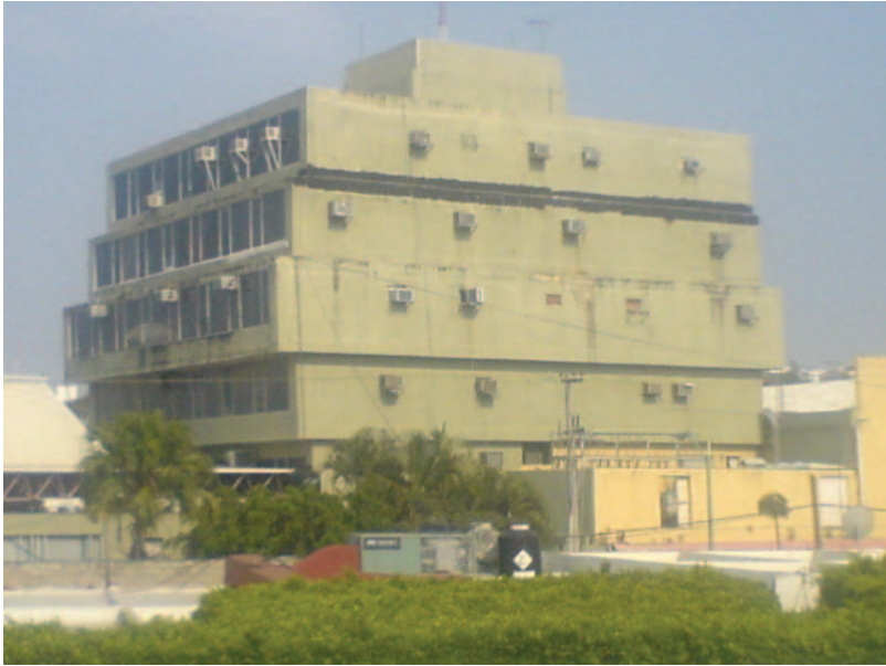
Figura 19. Irregularidad del edificio plaza de las instituciones en la ciudad de Tuxtla Gutiérrez
